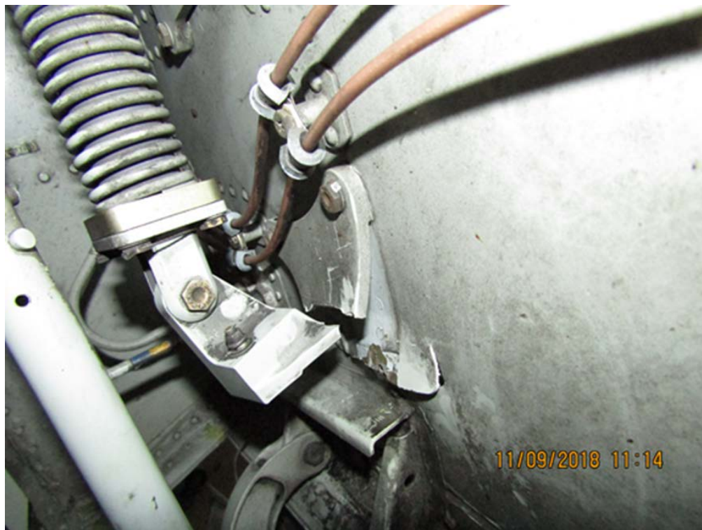
Figure 1 : Rupture de la ferrure vue de face.
