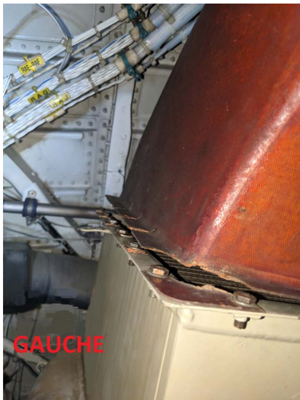
Fig 1 : Conduit gauche arrière et extérieur séparé de l'échangeur d'air
