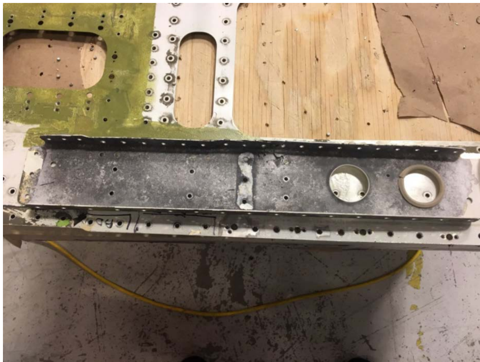
Fig. 1 : Dommages causés par la corrosion
